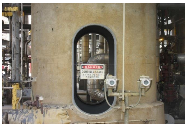
Waarschuwbord bevestigd op tankskirt met vrije toegang.
