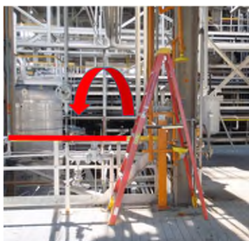
Een werknemer op deze trapladder loopt het risico om over de top van het reling te vallen.
